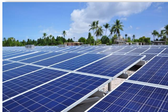
Parc solaire de Tarawa, République de Kiribati
